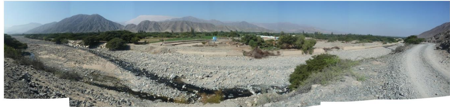
ZC-13. Sector de Orcona. En la margen izquierda del río Aja, se han colocado muros de concreto y arrimado de material de río para controlar los procesos erosivos y la inundación fluvial.
