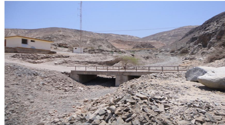
ZC-3. Sector de Sarmarca. Viviendas asentadas muy cerca de quebrada que se activa excepcionalmente y acarrea flujos.
