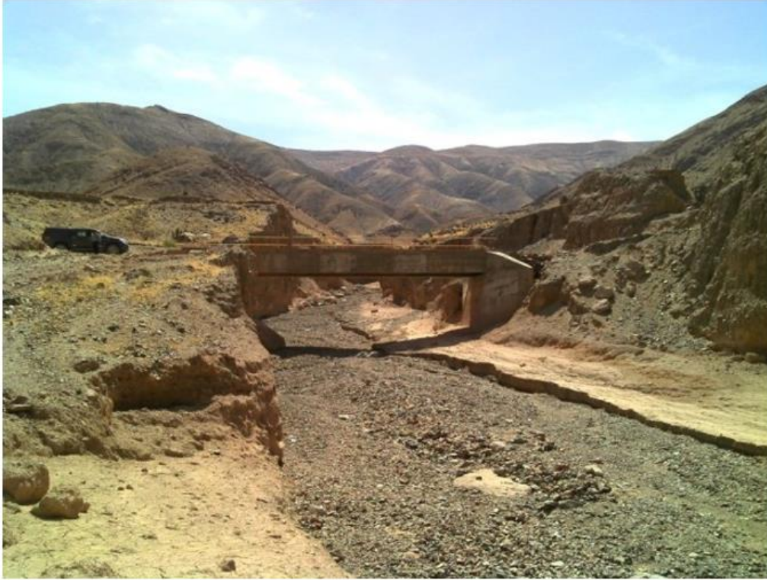
ZC-5. Quebrada Aparpo, carretera a Tibillo, que se activa excepcionalmente.
