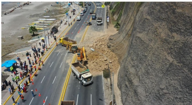
El derrumbe obstruyó un aproximado de 25 o 30 metros de la pista. (Foto: Daniel Apuy).
