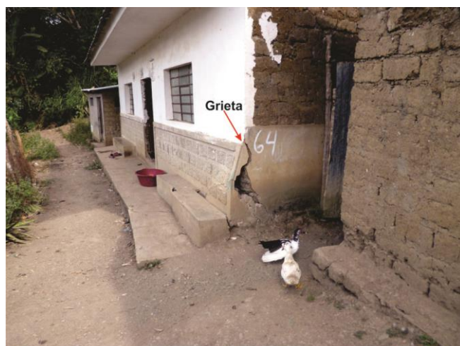
Foto 12: Vivienda agrietada en el sector de Cochapampa.
