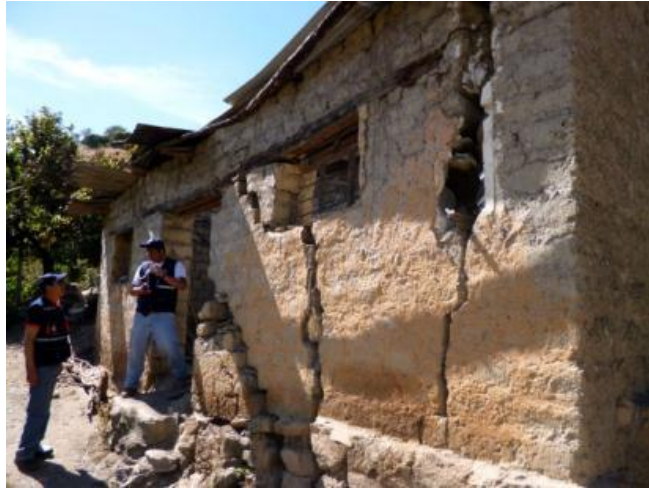
Foto 18: Vivienda agrietada en el sector de Sullucuyoc.
