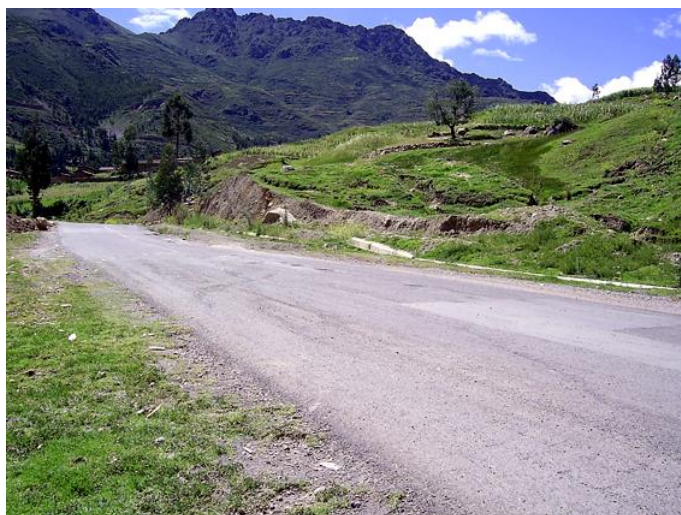
Foto 42: Asentamientos y pérdida de plataforma entre el km 4+100 al km 4+900 de carretera de acceso a Pisac y Paucartambo.
