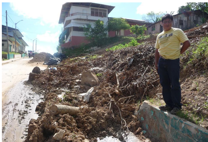
Foto N° 3: Calles Mariscal Castilla afectado por deslizamiento.
