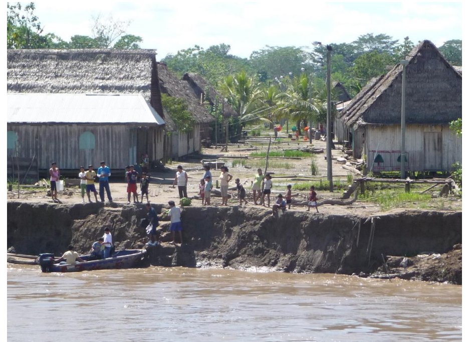
Foto N° 17: Obrero I, sector susceptible a inundaciones y erosión fluvial.
