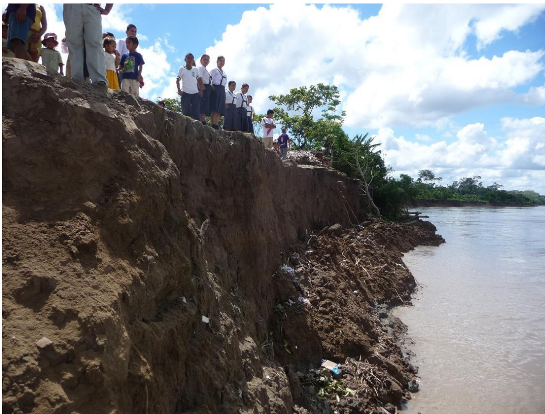
Foto 13: Nuevo Dos de Mayo, sector afectado por la erosión fluvial.
