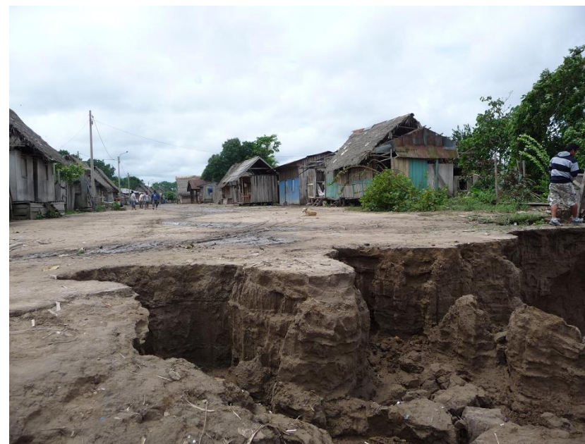
Foto N° 2: Sector Roaboya, vista de las viviendas que podrían ser afectados por la erosión fluvial.
