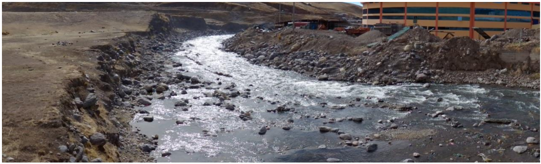
Foto 4. Sector Macusani, susceptible por inundación y erosión fluvial. Con la presencia de lluvias intensas, afectaría viviendas y el coliseo que se encuentra cerca al cauce.
