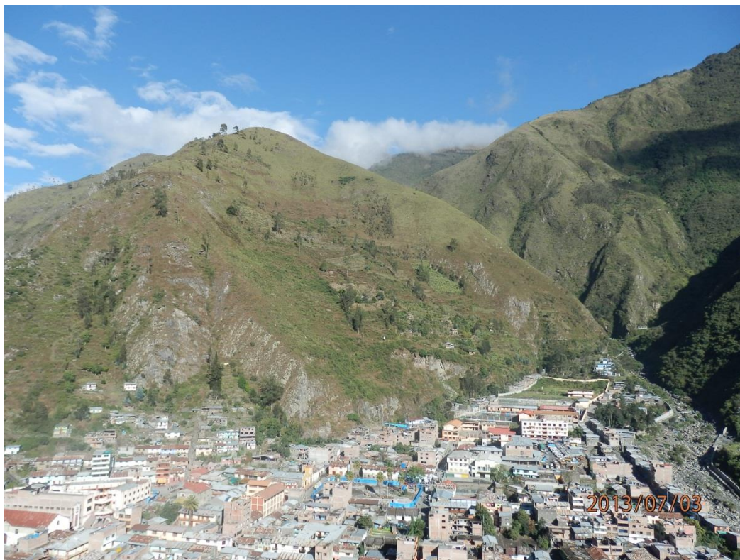
Foto 25. Vista panorámica del poblado de Sandia donde se puede observar zona de huaicos, derrumbes y talud de roca muy fracturada.
