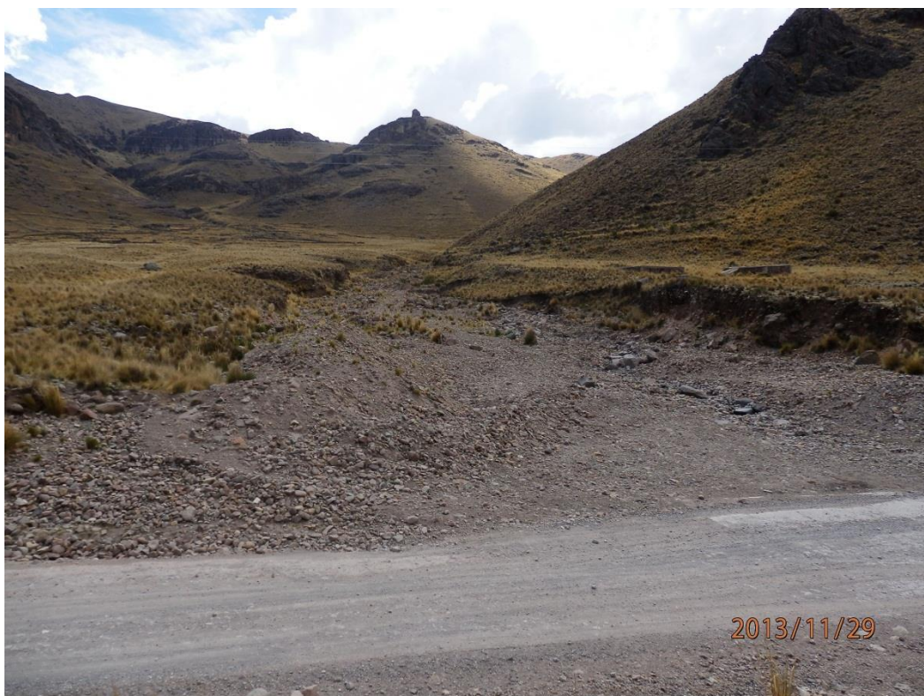
Foto 14. Quebrada ubicado en la progresiva 51+810 de la carretera al poblado de Condoriri es susceptible a flujos de detritos y derrumbes. Afecta tramo de carretera.
