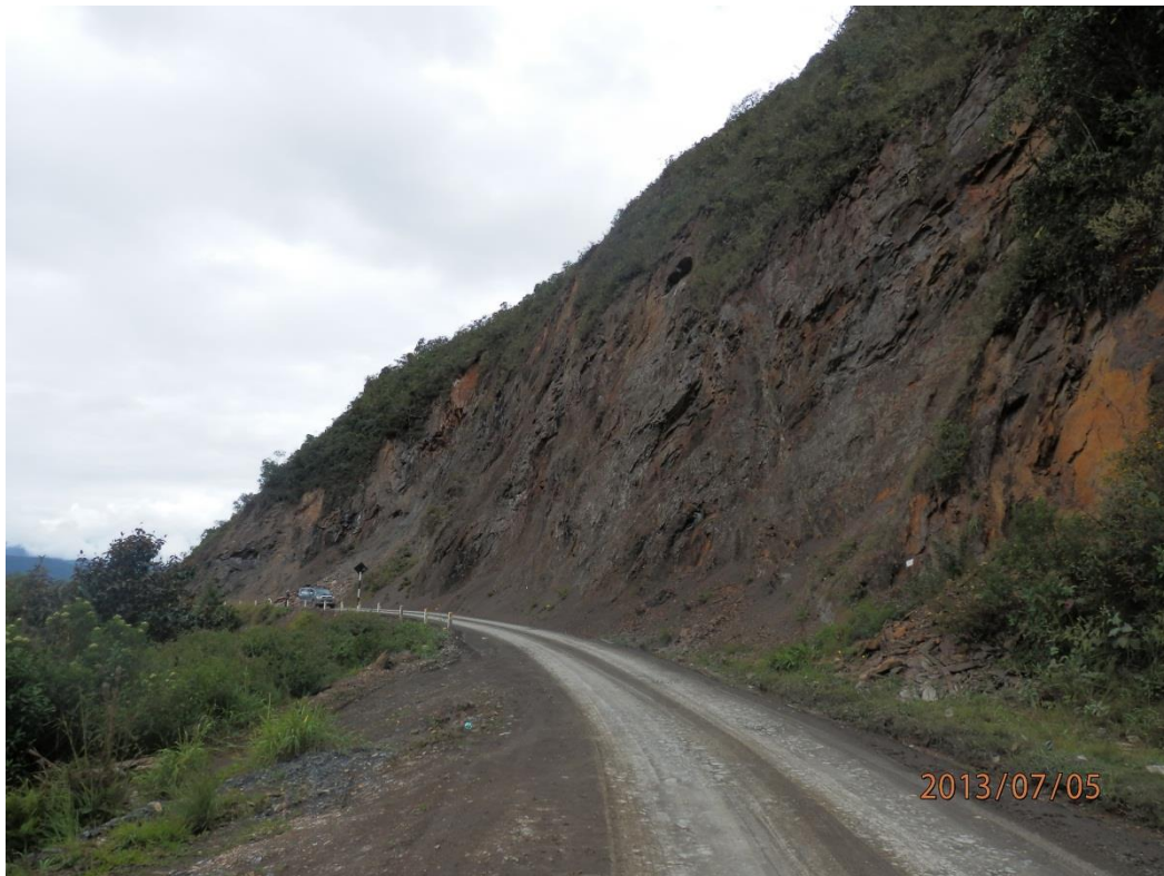
Foto 22. Sector Alto Santa Rosa, susceptible a derrumbes. Detonadas por lluvias intensas, afecta tramo de carretera Sandi – San Juan del Oro una longitud de 200 m. aproximadamente, también afectaría viviendas que se encuentran al pie del talud
