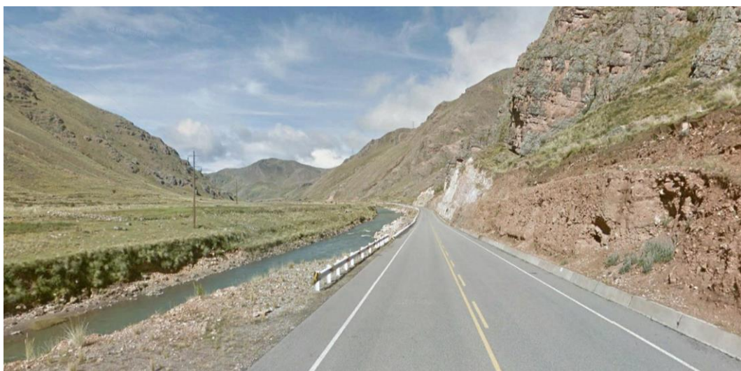
Foto 2. Vista Panorámica del sector de Vilacollo, susceptible por erosión fluvial y derrumbes. Afecta tramo de carretera interoceánica.
