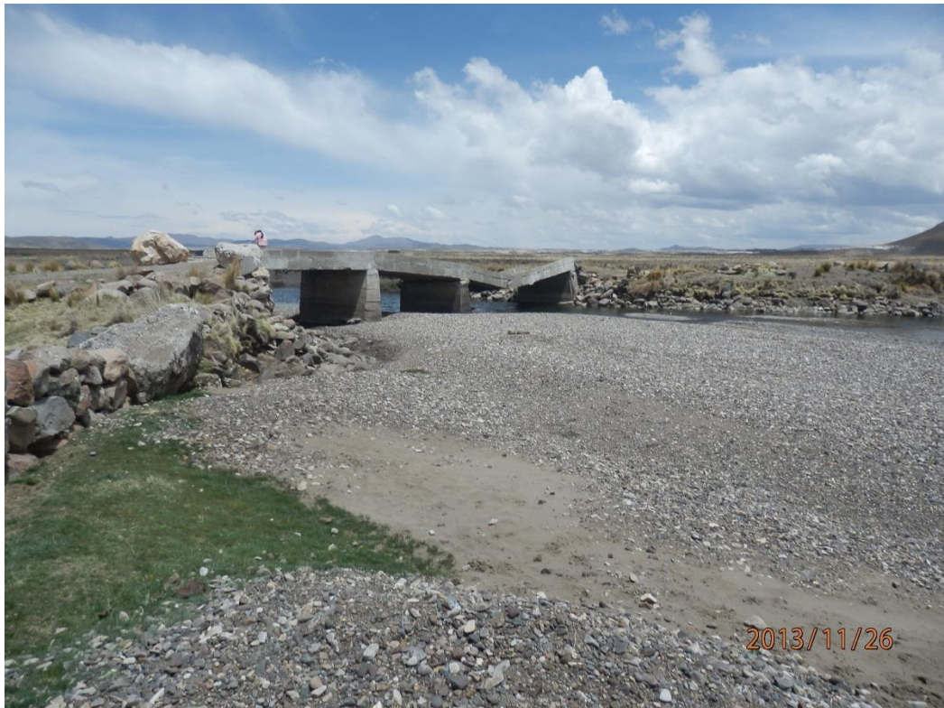
Foto 18. Tramo de acceso al poblado de Viluyo, se observa los daños a la base del puente colapsando.
