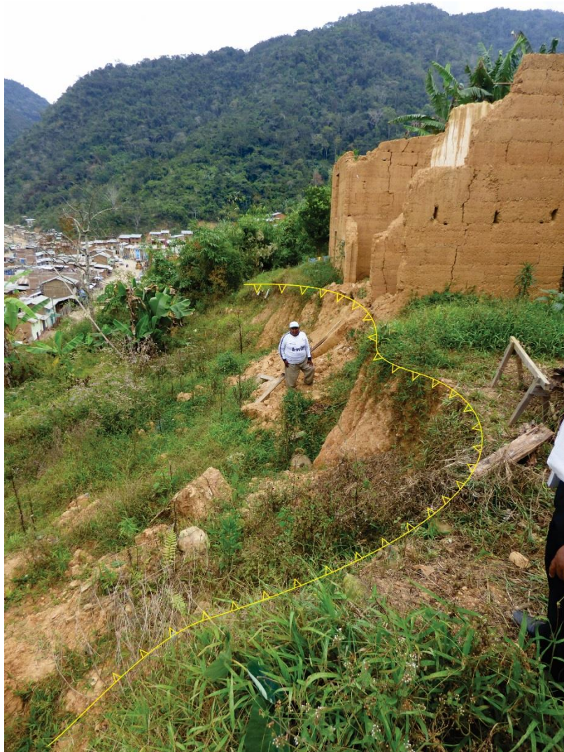
Foto 27. Vista donde se observa la escarpa de deslizamiento que ocasiono daños algunas viviendas
