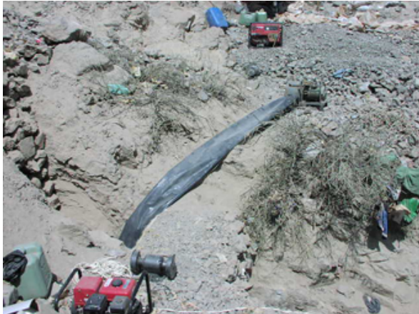
Vista que muestra motor, ventilador y manga en disposición para ser operado en pique que supera los 80 m de profundidad-mina Santa María Tulin.
