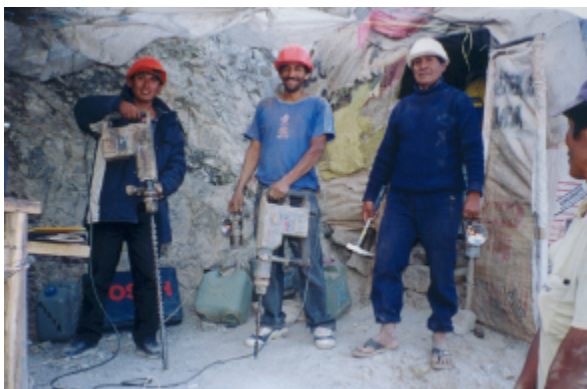
Vista de perforadoras eléctricas con barrenos de dimensiones variables. Mina 4 Horas-Cháparra.
