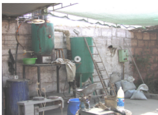
Tanque de desorción de carbón activado para minería de pequeña escala (planta piloto Parque Industrial-Arequipa).
