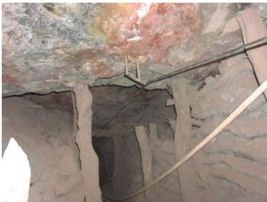
Foto N° 13 Sostenimiento de cajas con puntales de Huarango Mina Sol de Oro - Nasca
