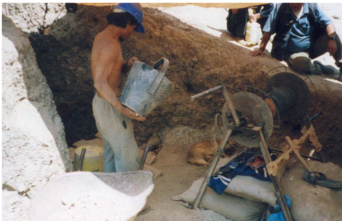
Foto N° 10 Extracción de mineral a través de winches manuales Mina Lomo Camello - Tulin
