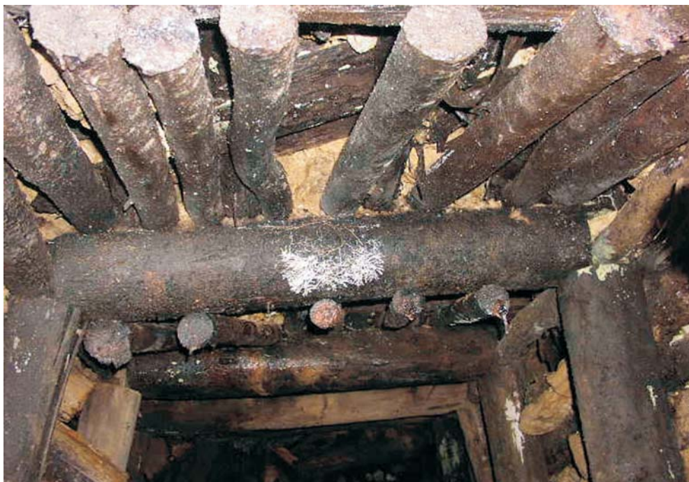
Foto 25 Mina Ccarihuarmi, disposición de sostenimiento en interior mina
