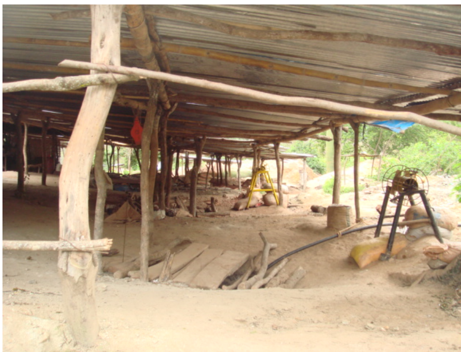
Foto 4.11 Instalaciones temporales cubiertas con calaminas, donde se disponen los sistemas de extracción y suministros para el descenso a las labores en posición vertical (sector Cuchicorral).
