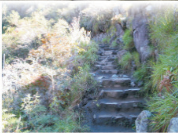
Foto 3. Erosión superficial en el camino inca.
