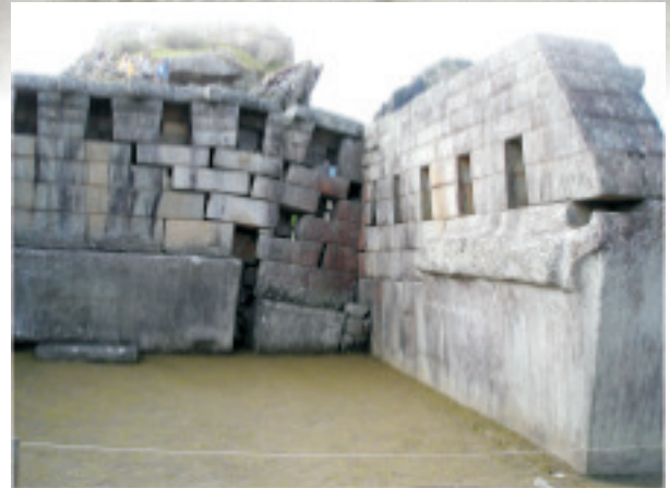
Foto 4. Asentamiento en el Templo Principal
