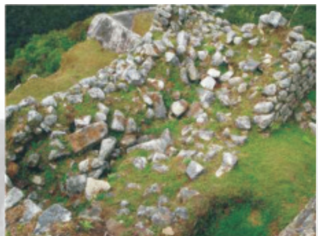
Foto 2. Proceso de sufusión que ha causado el colapso de muros en este recinto (Conjunto 13)
