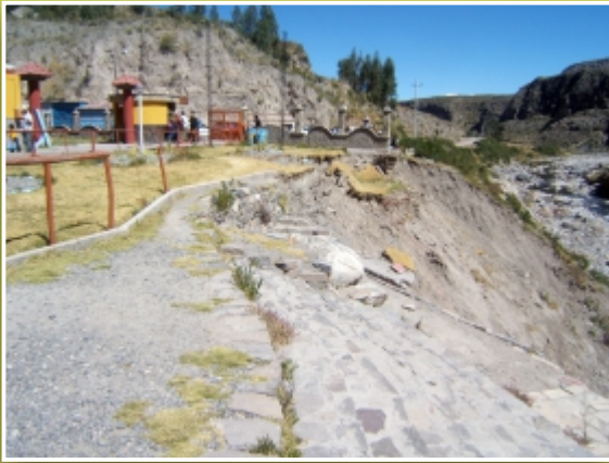
Deslizamiento; baños termales La Calera
