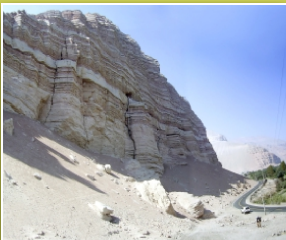
Taludes en rocas muy fracturadas susceptibles a derrumbes; carretera Corire - Aplao
