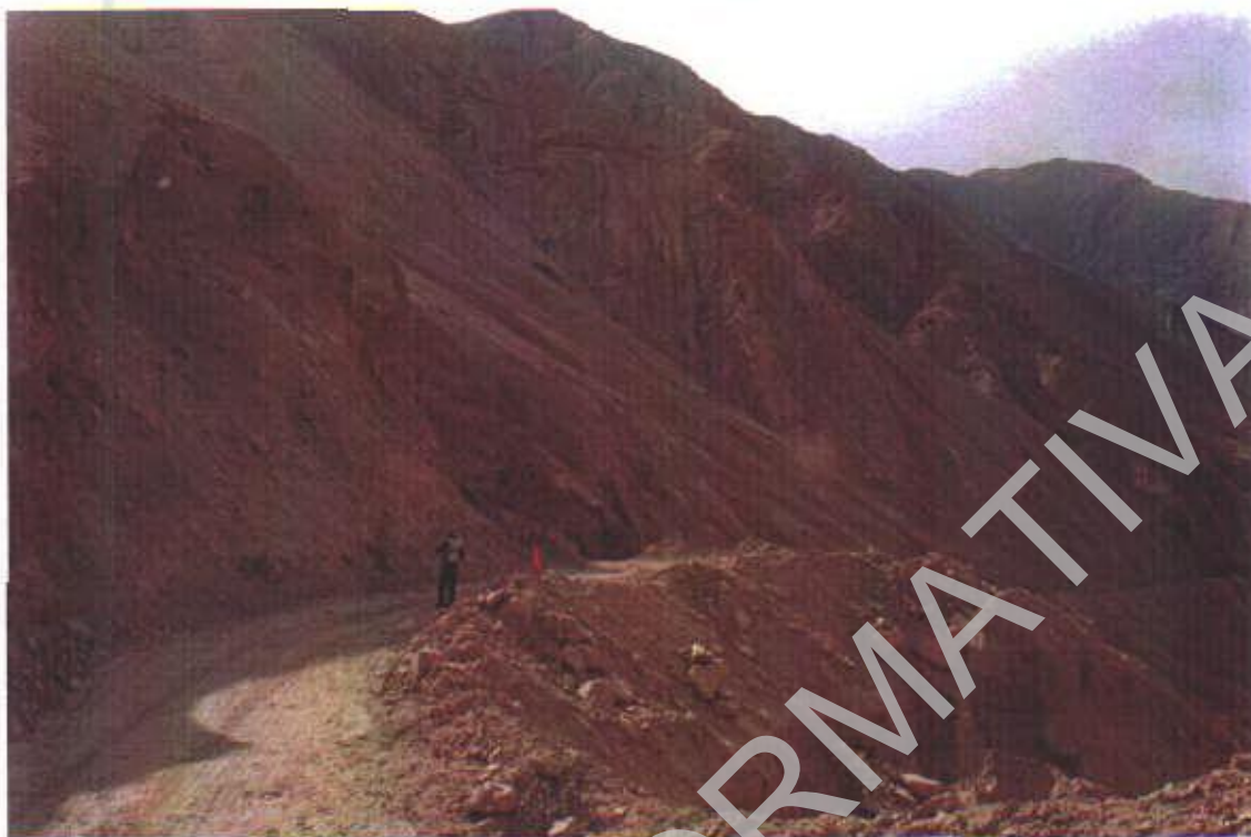
Foto N° 107 Sector Crítico N° 20. Taludes inestables en carretera Aplao-Viraco, sector Capiza, cerro Andamayo, derrumbes incentivados por sismos o lluvias
